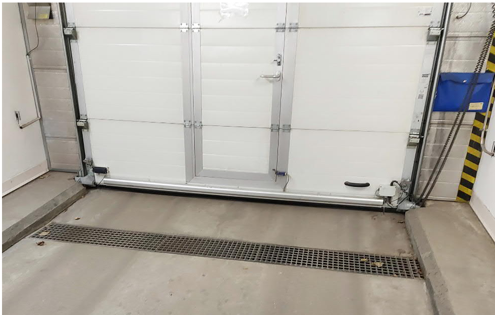
Kuva 3. Pysäköintihallin sisäpuolen linjakuivatussäleikkö.
